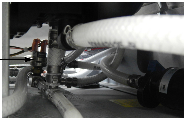
Figura 53. Vista Del Interruptor De Presión De Agua
